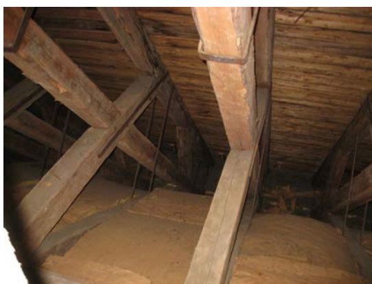
Figur 21. Randmönstrad försmutsning av tak, orsakad av kalla ytor som uppstått p g a takstolar på vinden som fungerar som köldbryggor mellan isoleringen. IR-termografi uppe till höger.
