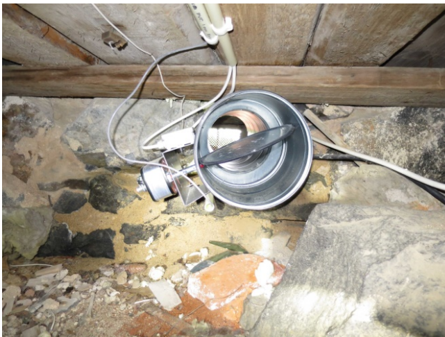
Figur 14. Fuktstyrt ventilationsspjäll i krypgrundsventil.
